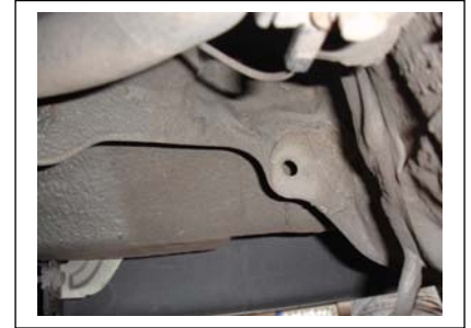
Lochbild durch Unterboden- Schutz nicht sichtbar
